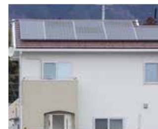
整備された太陽光発電設備
