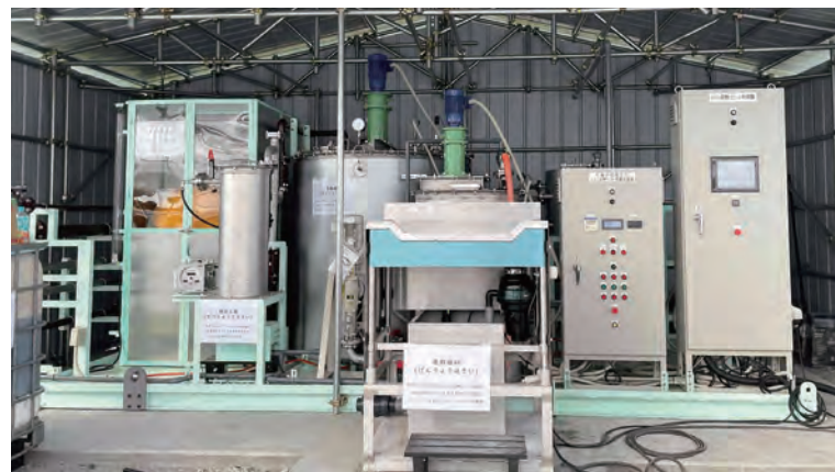
ワタミオーガニックランド内に設置されている実証機
