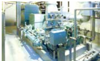
更新する発電機
