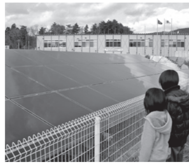
市役所前の太陽光パネル
