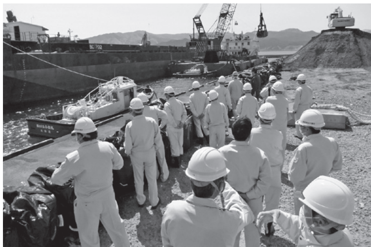
5月14日、がれき二次仮置場で運搬船への積み込み状況を視察
