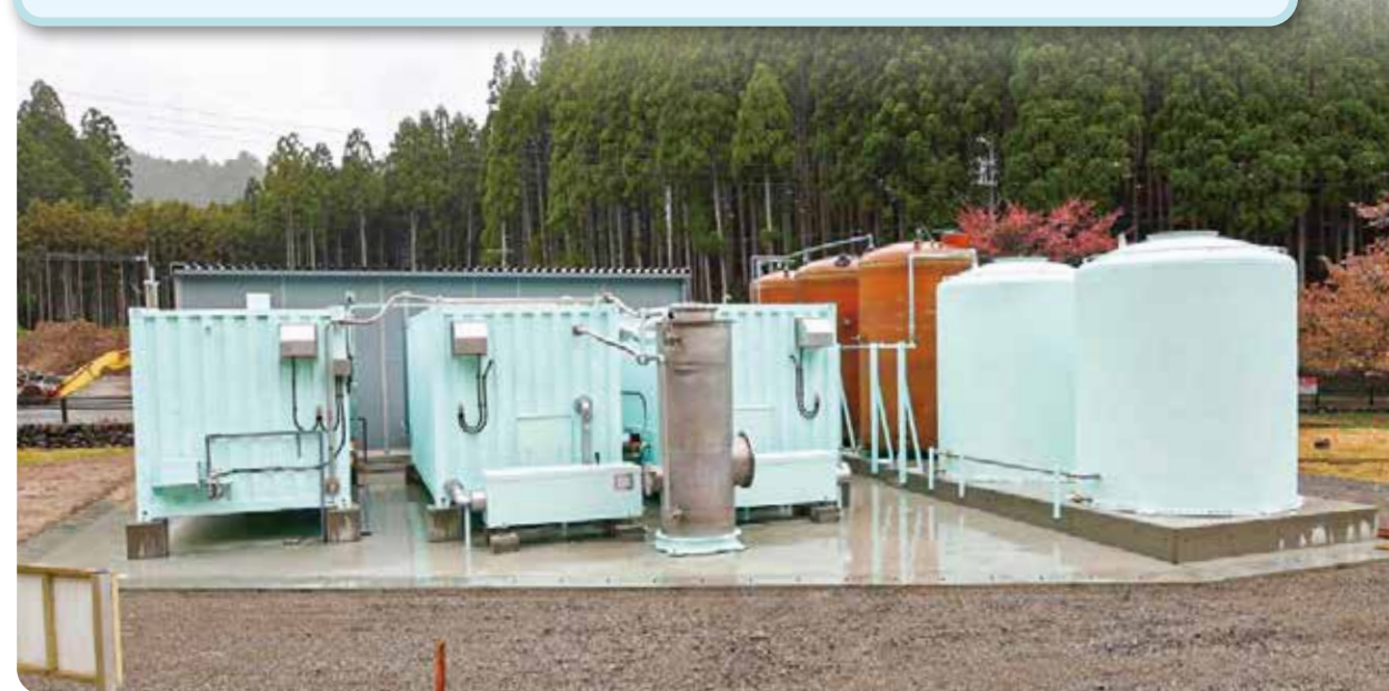
メタン発酵バイオガス発電設備の一例
