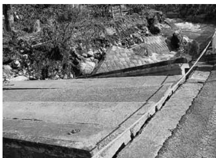
令和元年台風19号による被害（横田町）
