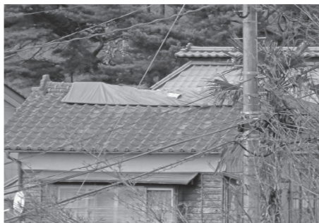
一部損壊住宅
