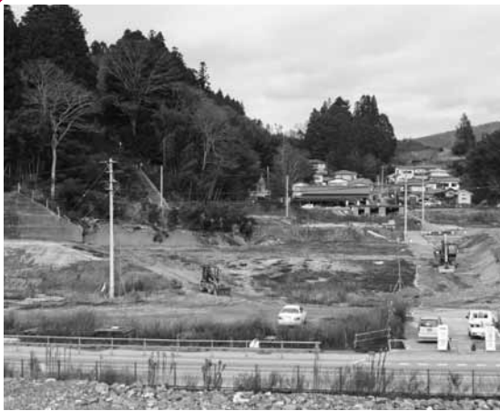
周辺部を含め中心市街地の避難路整備が求められる (高田町)
